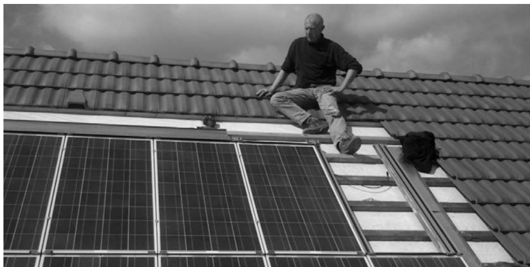
Une grande surface de toiture favorise l'implantation de panneaux photovoltaïques (ci-dessus une réalisation de l'entreprise JET Energies)
